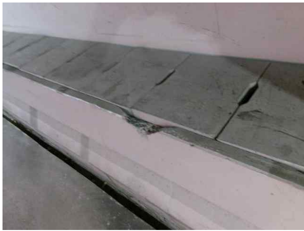
공동구 BB07 파손
