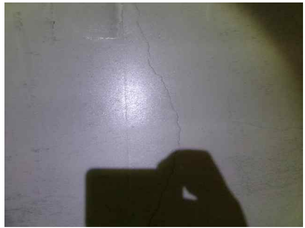
NATM구간 측벽부 S793 균열(Cw=0.3mm)
