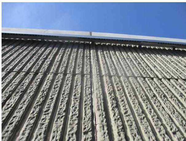
중점부 일직방향 실란트파손
