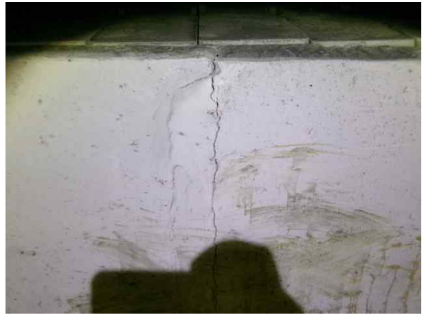
공동구 S605 균열
