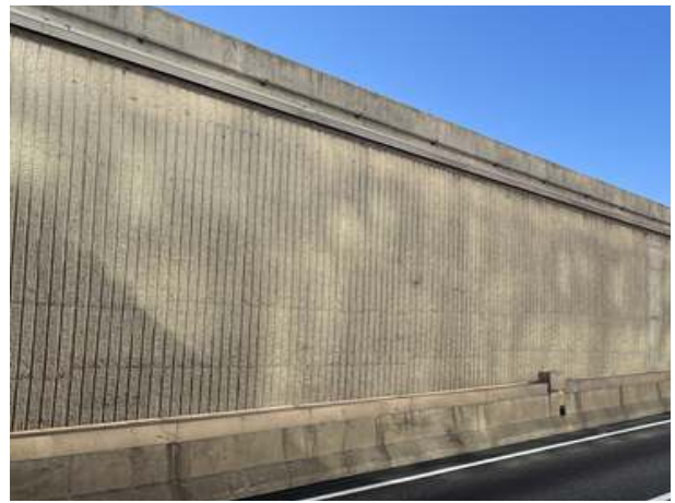
시점부 성산방향 균열(Cw=0.2mm)
