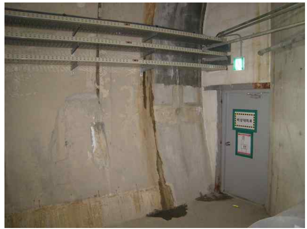
공기정화시설#2 라이닝 누수(스며있음)
