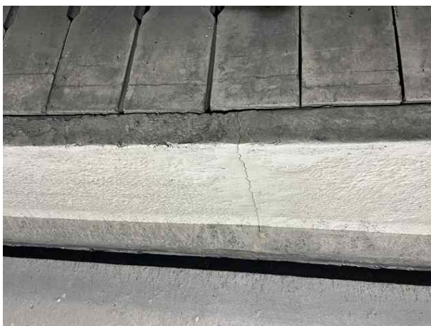
공동구 S142 균열
