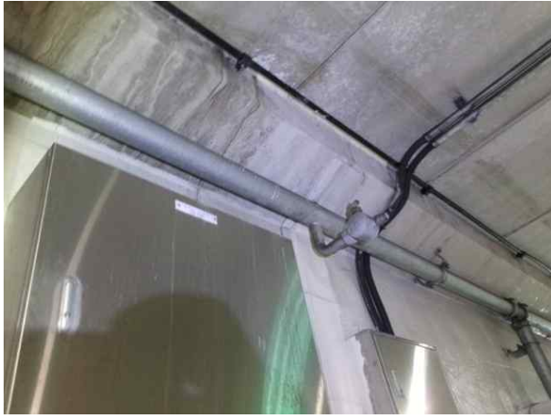
BOX구간 측벽 BB11 누수흔적
