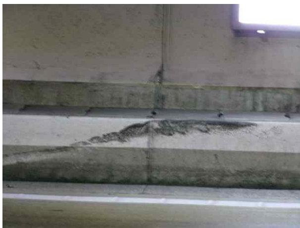
공동구 S736 균열
