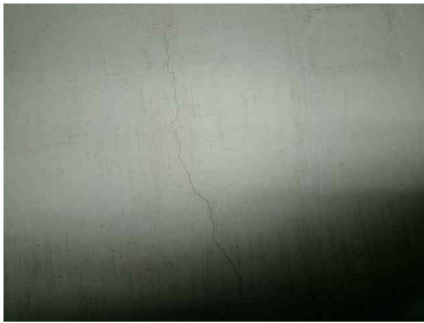
NATM구간 측벽부 S692 균열(Cw=0.3mm)
