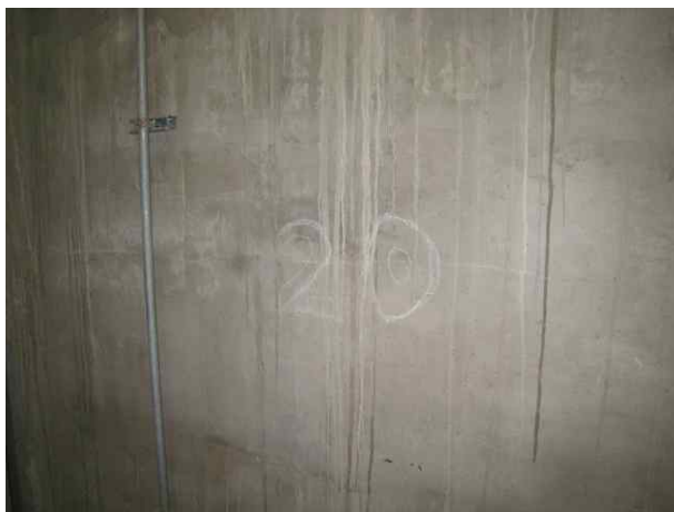
공기정화시설#1 수직구 20F 균열(Cw=0.1mm)
