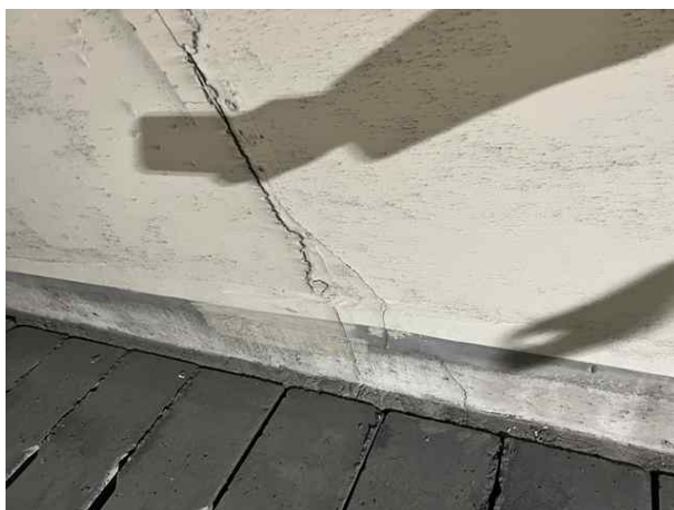
NATM구간 측벽부 S079 균열( C_w=0.2\text{mm} )
