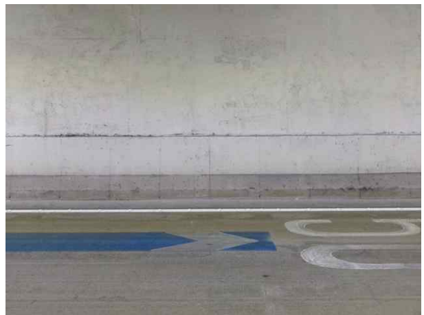
BOX구간 측벽 BB22 균열(Cw=0.2mm)
