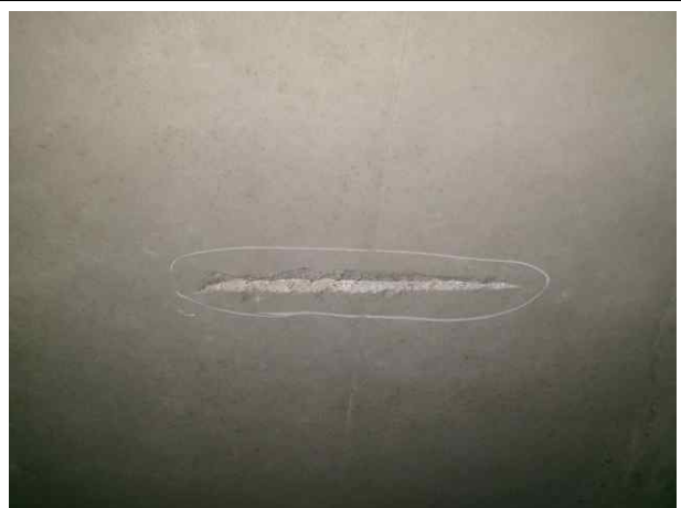
NATM구간 천정부 S100 균열
