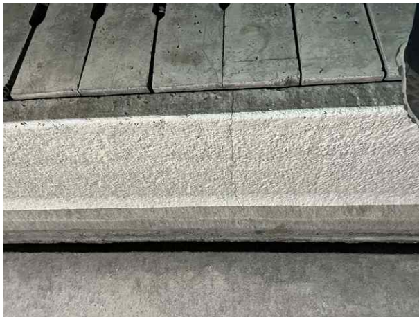
공동구 S018 균열
