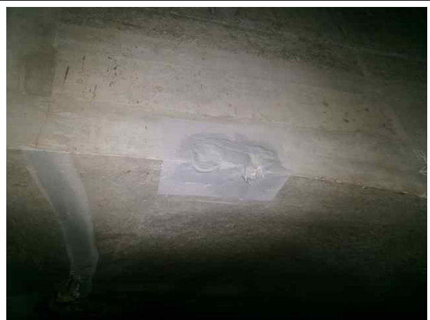
NATM구간 천정부 파손보수 양호
