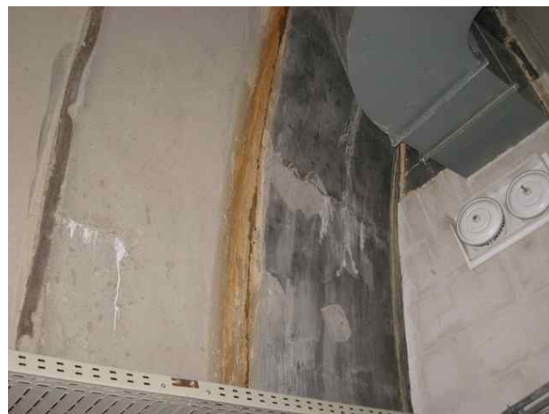
공기정화시설#2 라이닝 백태
