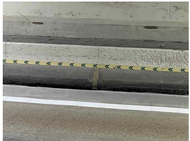
공동구 S027 균열
