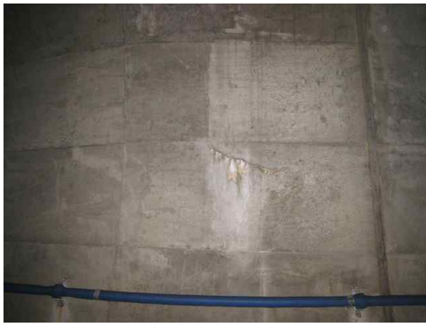
공기정화시설#1 라이닝 백태
