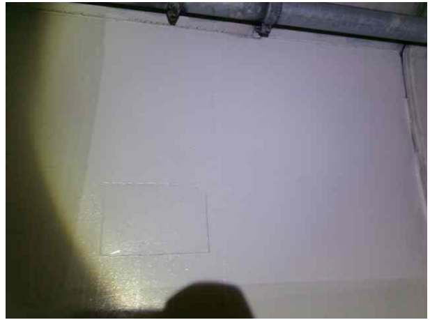
NATM구간 측벽부 도장탈락보수 양호
