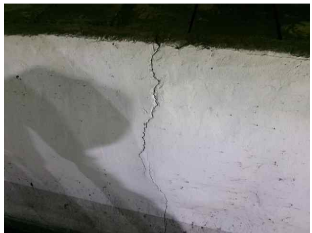
공동구 S653 균열
