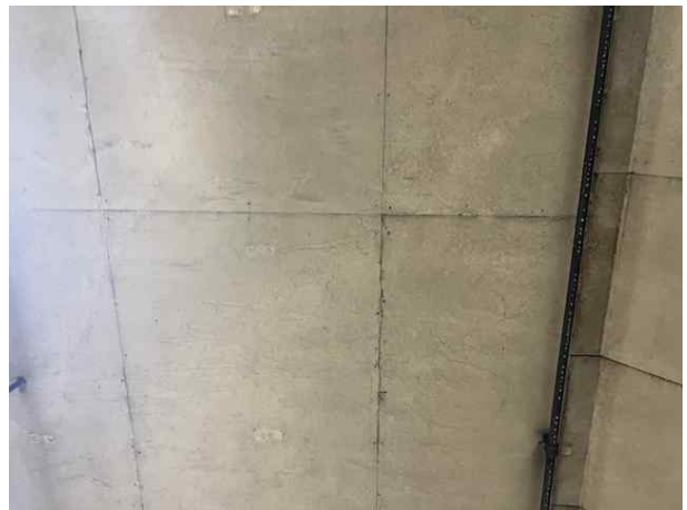
BOX구간 슬래브 BB01~07 망상균열(Cw=0.1mm)
