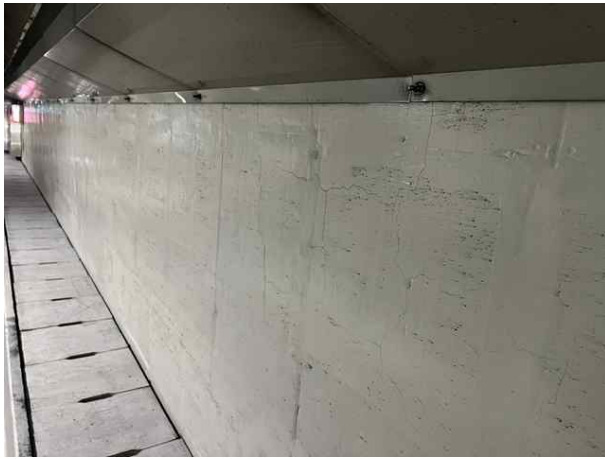
BOX구간 측벽 BB06 도장 망상균열(Cw=0.1~0.2mm)
