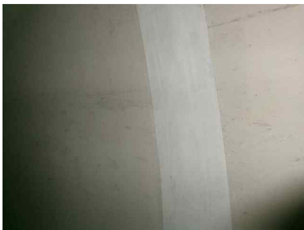
NATM구간 측벽부 재균열보수 양호
