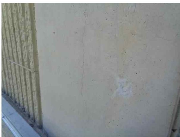
중점부 일직방향 균열(Cw=0.2mm)
