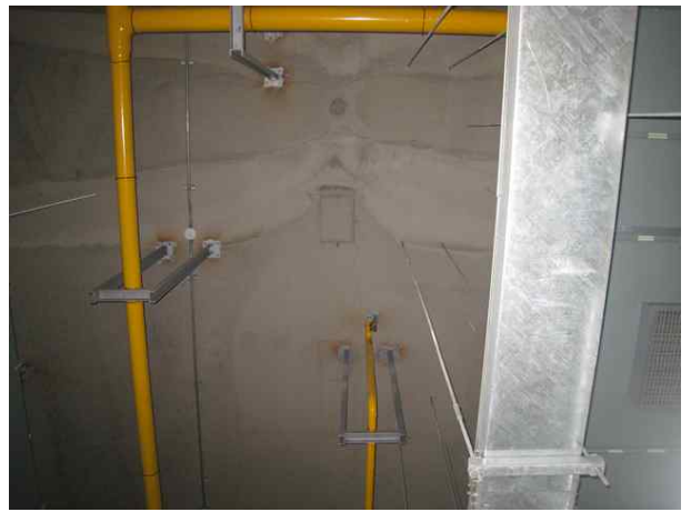
공기정화시설#1 전기실 천단부 균열(Cw=0.5mm)
