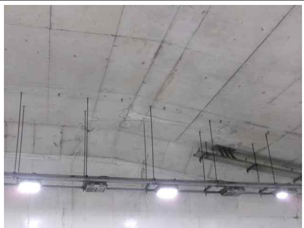
BOX구간 슬래브 BB22 백태
