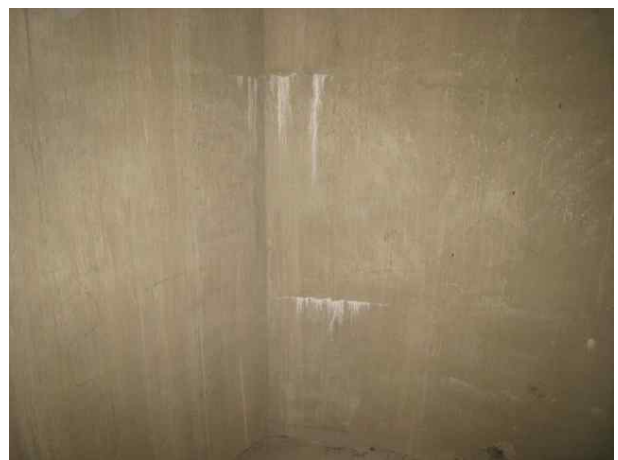
공기정화시설#2 수직구 2F 백태
