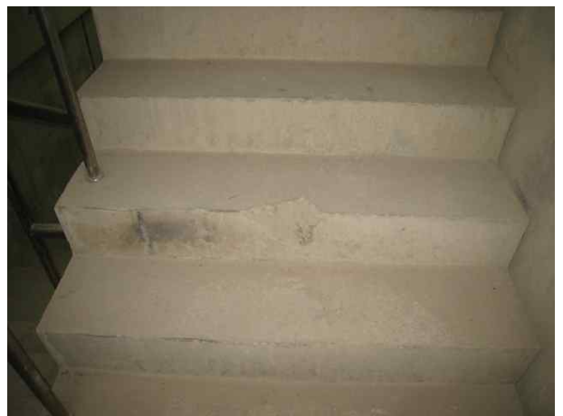
공기정화시설#1 수직구 22F 파손
