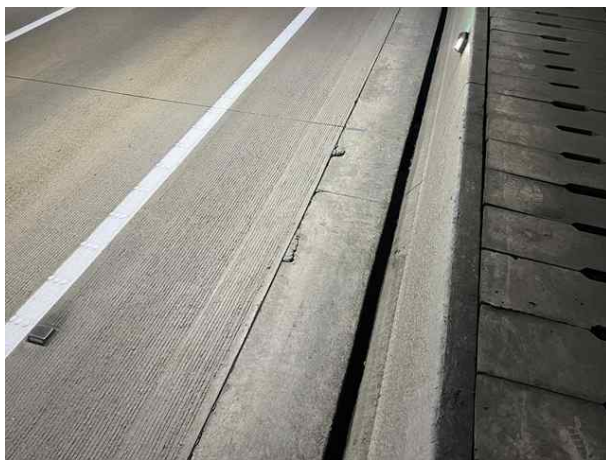
포장부 S260 파손
