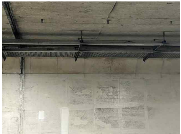
BOX구간 측벽 BB01 현치부 균열(Cw=0.2mm)
