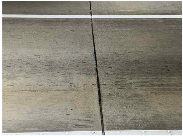
포장부 S137 파손
