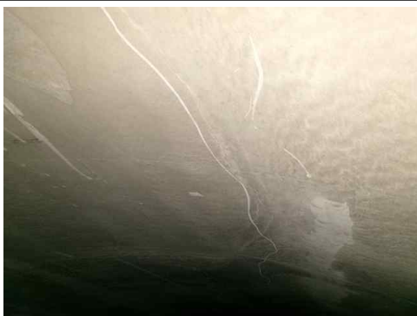
NATM구간 천정부 S096 균열( C_w=0.5\text{mm} )
