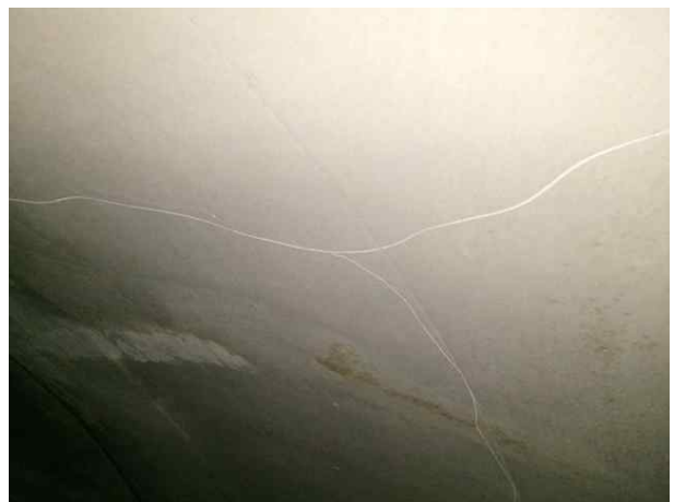
NATM구간 천정부 S095 균열( C_w=0.5\text{mm} )
