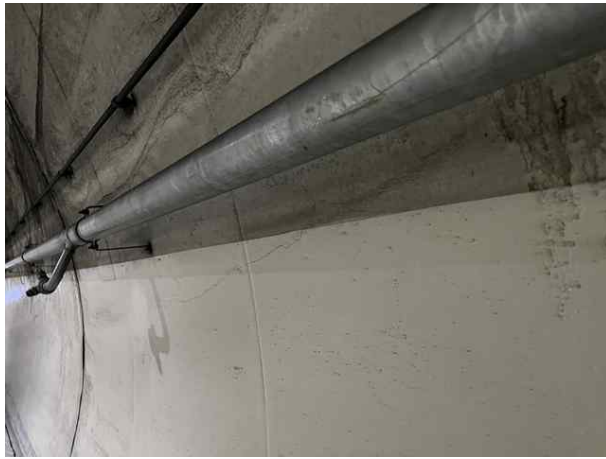
NATM구간 측벽부 S006 균열( C_w=0.2\text{mm} )
