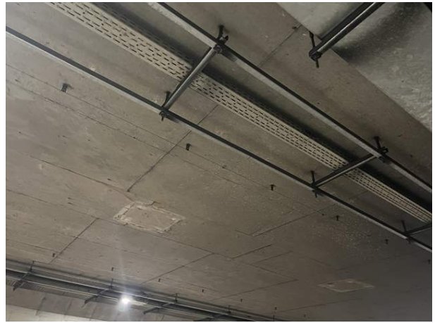
BOX구간 슬래브 B01~07 망상균열(Cw=0.1mm)
