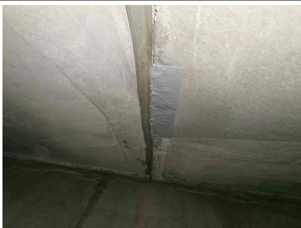
NATM구간 천정부 박락보수 양호
