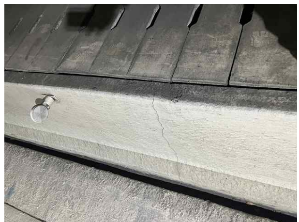
공동구 S278 균열
