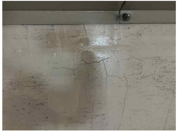
BOX구간 측벽 BB06 도장 망상균열(Cw=0.1~0.2mm)
