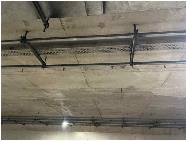
BOX구간 슬래브 B01~07 망상균열(Cw=0.1mm)
