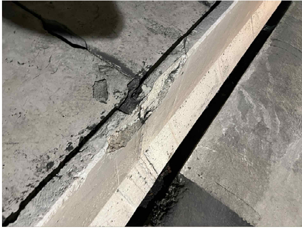
공동구 BB06 파손
