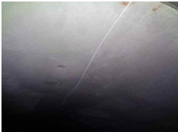
NATM구간 천정부 S791 균열(Cw=0.5mm)
