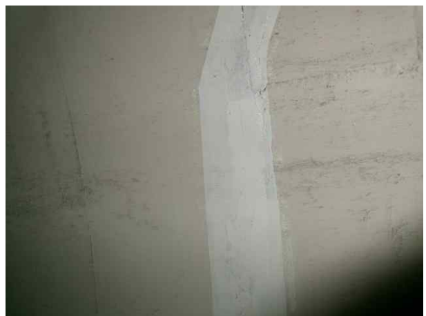
NATM구간 측벽부 재균열보수 양호
