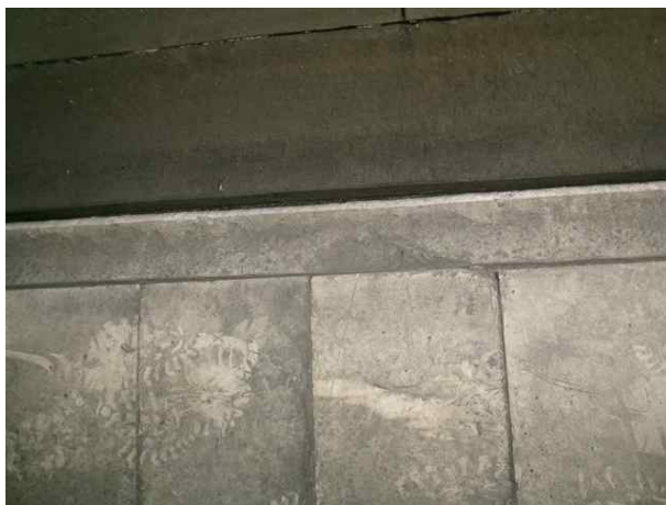
공동구 S438 파손
