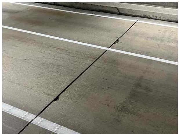
포장부 S299 파손
