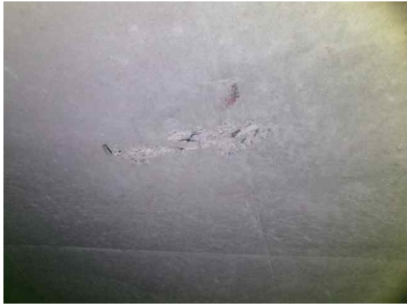
NATM구간 천정부 S745 파손
