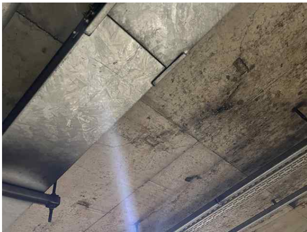
BOX구간 슬래브 BU01~06 망상균열(Cw=0.1mm)
