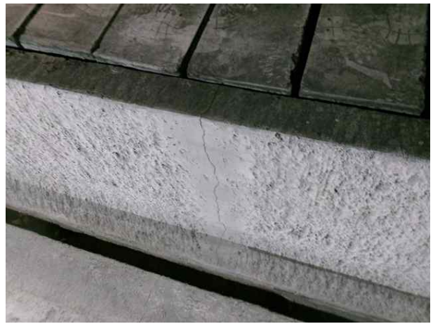
공동구 S073 균열
