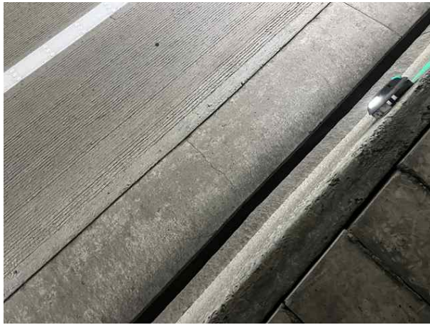
포장부 S033 균열
