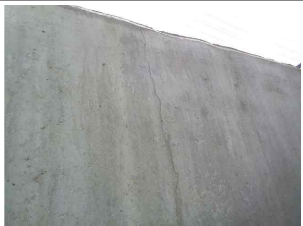
중점부 성산방향 균열(Cw=0.2mm)
