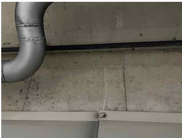
BOX구간 측벽 BB05 현치부 균열(Cw=0.2mm)
