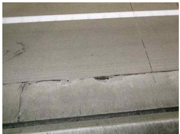
포장부 S376 파손
