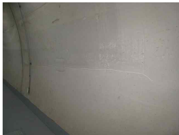
공기정화시설#2 전기실 라이닝 균열(Cw=0.3mm)
