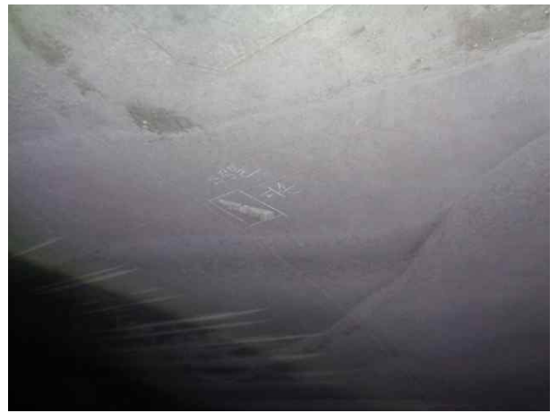
NATM구간 천정부 S820 파손
