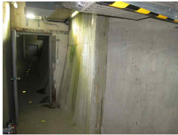
공기정화시설#2 라이닝 누수흔적
