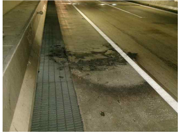
공동구 BU03 화재흔적구간 점검
