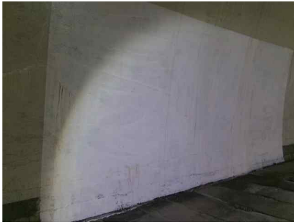
NATM구간 측벽부 백태보수 양호
