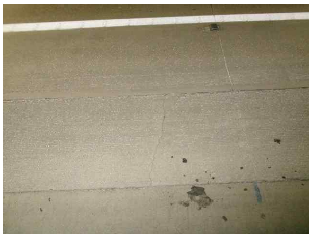
포장부 S318 균열
