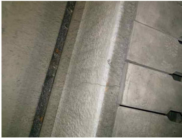
공동구 S433 균열
