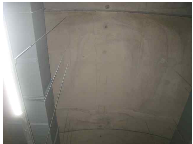
공기정화시설#2 전기실 라이닝 균열(Cw=0.5mm)
