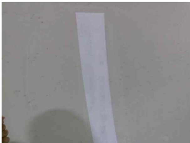
NATM구간 측벽부 균열보수 양호
