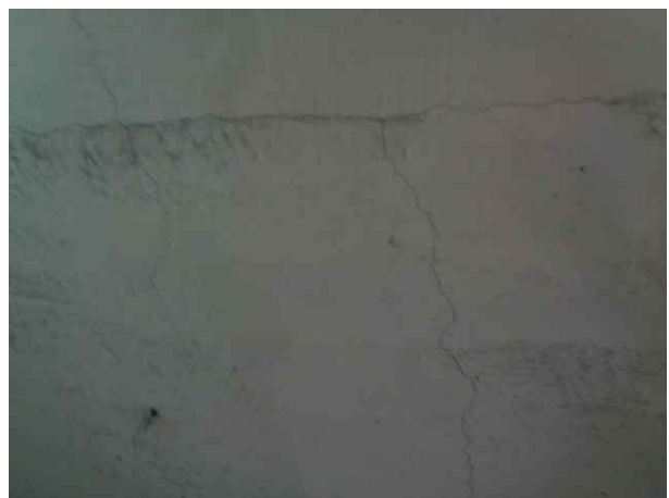
NATM구간 측벽부 S603 균열( C_w=0.3\text{mm} )
