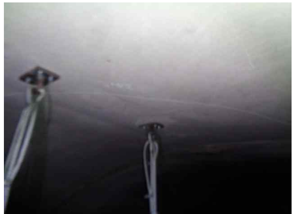
NATM구간 천정부 S792 균열(Cw=0.3mm)
