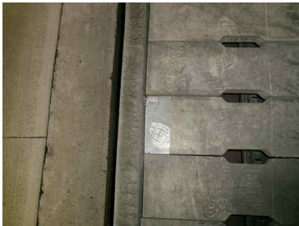
공동구 덮개파손 보수 양호
