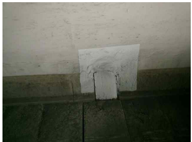
NATM구간 측벽부 파손보수 양호
