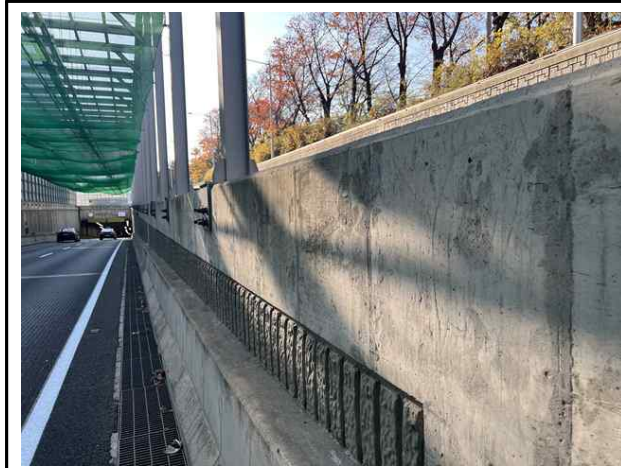
시점부 일직방향 균열(Cw=0.2mm)
