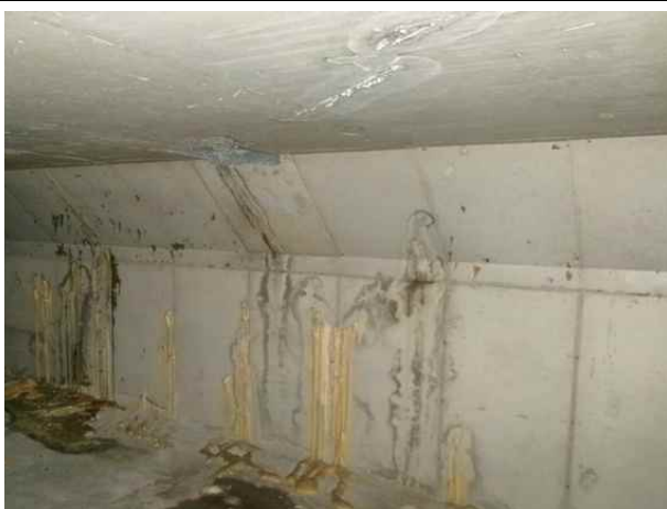
BOX구간 슬래브 BB11 누수(스며있음)
